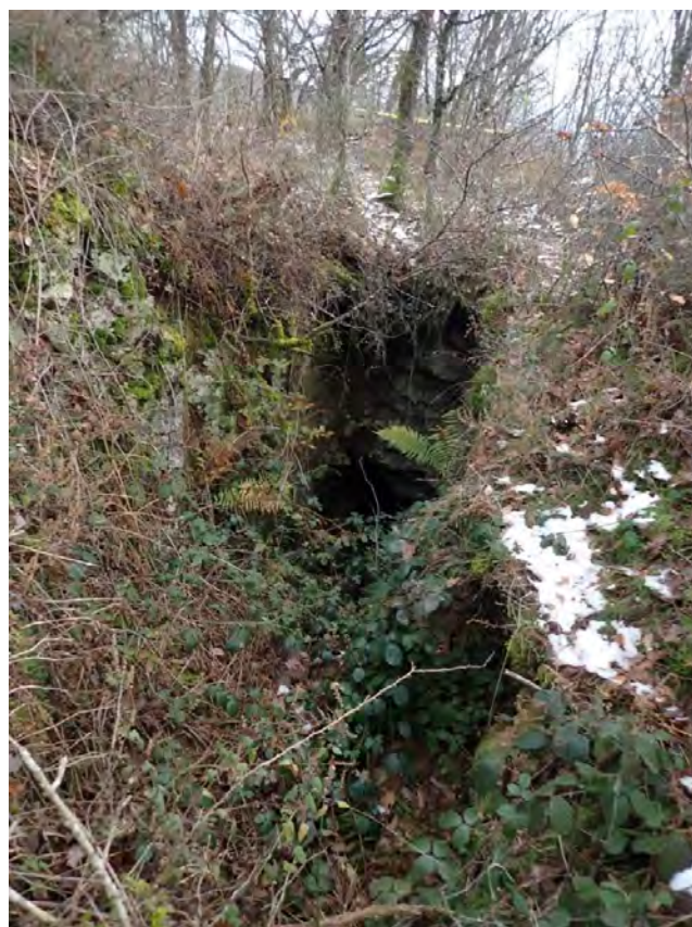
N3-g : Sommet du puits est instable
