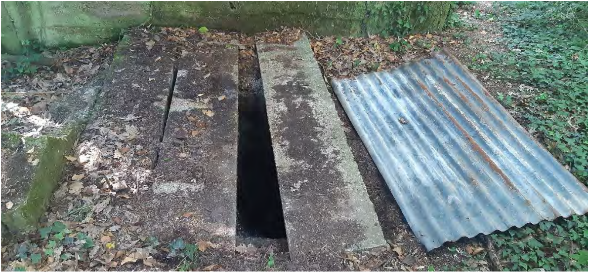
N3-i : Espacement entre les dalles de béton (largeur des dalles de 50 cm)
