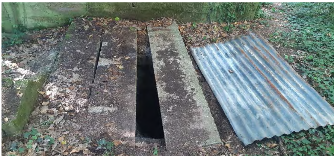
Vue extérieure du puits avec une mauvaise jointure entre les dalles béton
