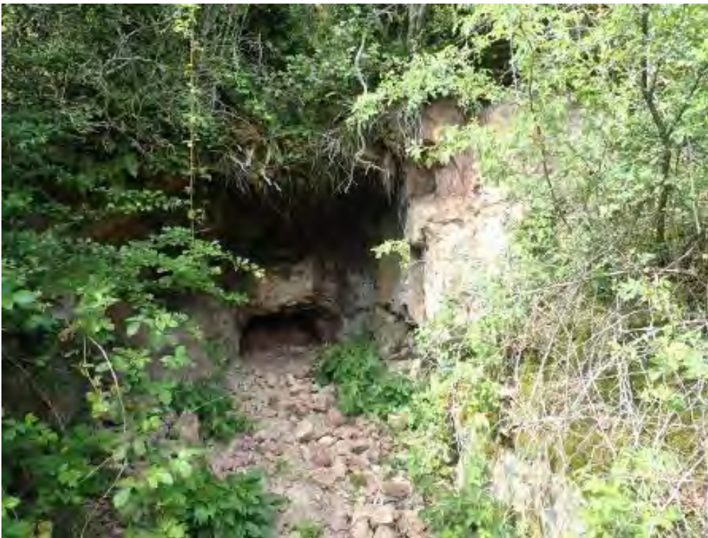
Sous-cavage en extrémité amont du N1-b
