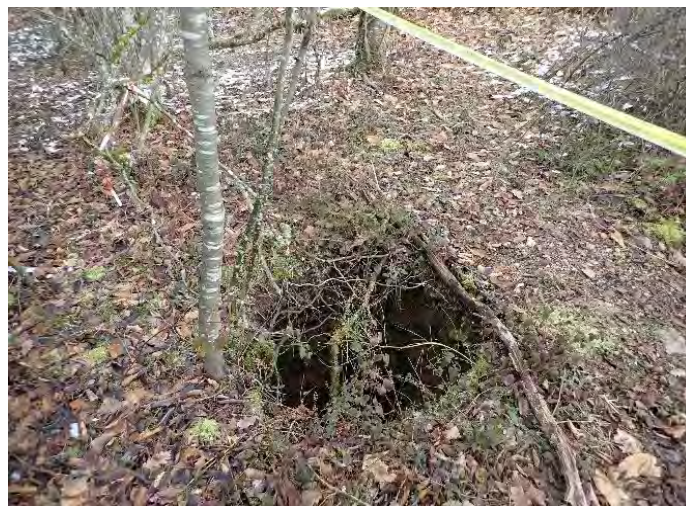
N3-f : Fontis en cours d'ouverture
